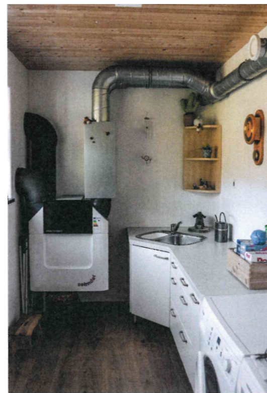
Die Komfortlüftungsanlage tauscht kontinuierlich Luft aus – geräuschlos und ohne Zuglufterscheinungen
