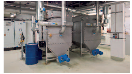
Aufstellung der HUBER Abwasserwärmeübertrager RoWin BGG in der Heizzentrale des Museums
